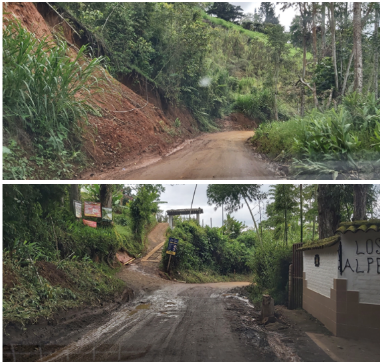
Figura 15. Deslizamientos y agua sobre la vía. Fotografía Diego Corrales.
