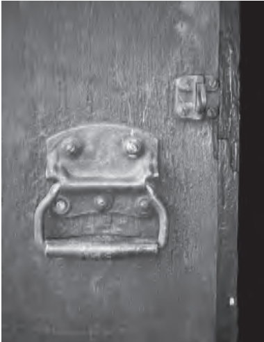
Imagen 63 Tipo de Aldaba que se encuentra en una de las puertas de acceso a la Iglesia.
