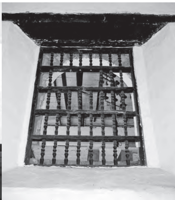
Imagen 139 La carpintería de madera en el salón del segundo nivel se encuentra en mal estado por el ataque de xilofagos. Fuente: CITCE - Universidad del Valle
