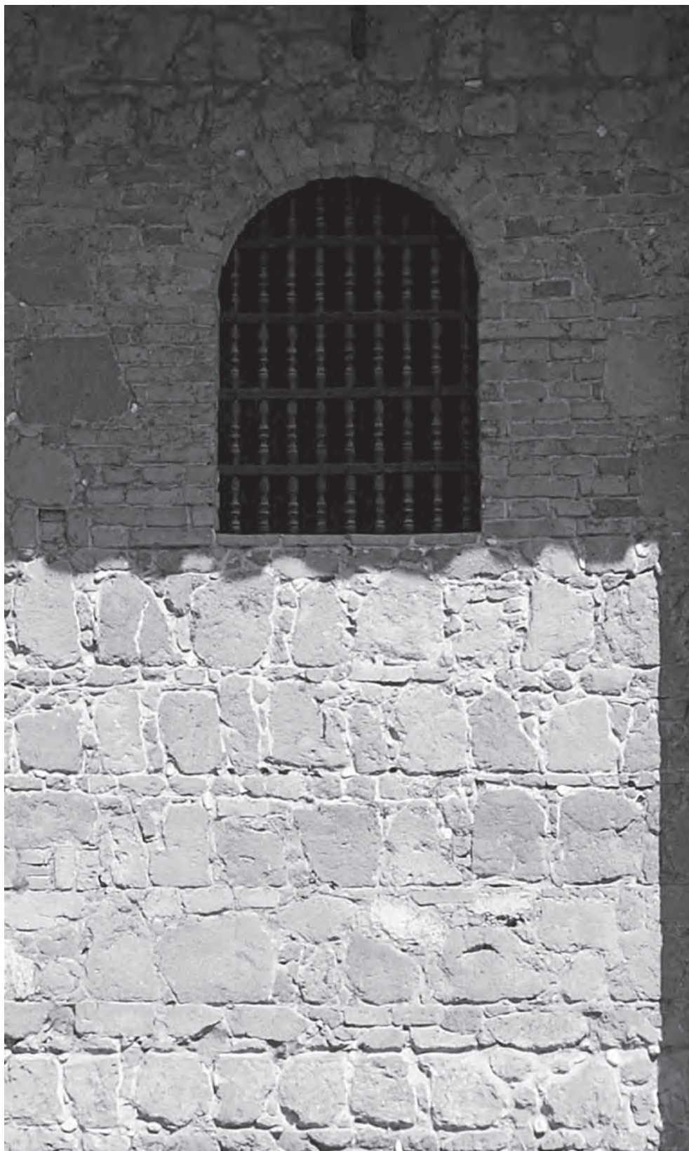
Imagen 2 Detalle de muro maestro en la fachada lateral de la Iglesia de Guadalupe. Fuente: CITCE - Universidad del Valle
