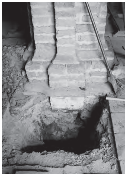
Imagen 103 Izquierda. Cimentación en Machones o Columnas en Mampostería. Fuente: CITCE - Universidad del Valle
