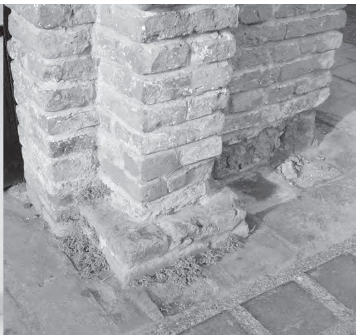
Imagen 140 La parte inferior de los muros que dan al exterior se presentan eflorescencias y subflorescencia de sales que han originado la erosión y el desprendimiento de algunas piezas. Fuente: CITCE - Universidad del Valle
