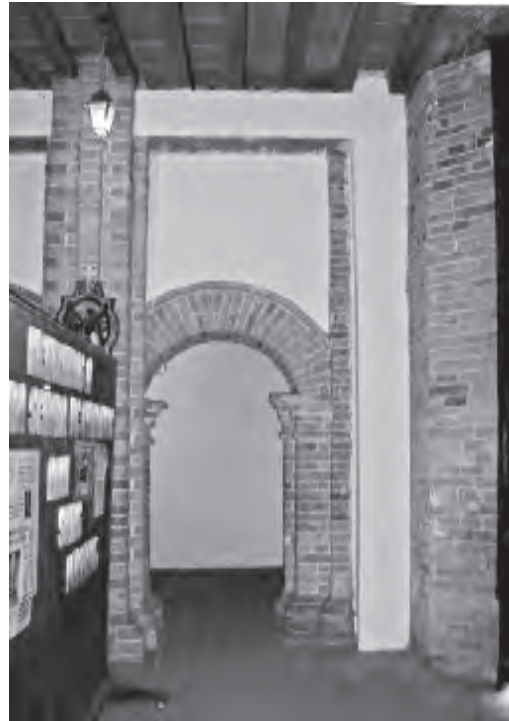
Imagen 85 Los elementos de la nueva estructura -la columna tras el enchape de ladrillo y la viga en la parte superior de esta- obligaron la sobrelevación del nivel del coro central. Fuente: CITCE - Universidad del Valle.
