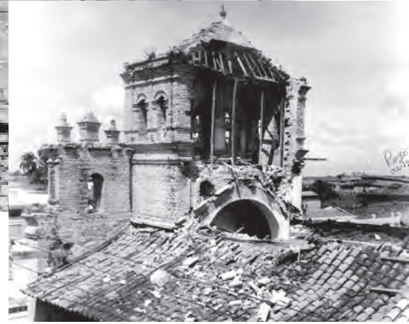
Images 90 - 91 Aspectos del edificio después del terremoto de 1962. Fuente: Archivo Fotográfico Foto Rayo
