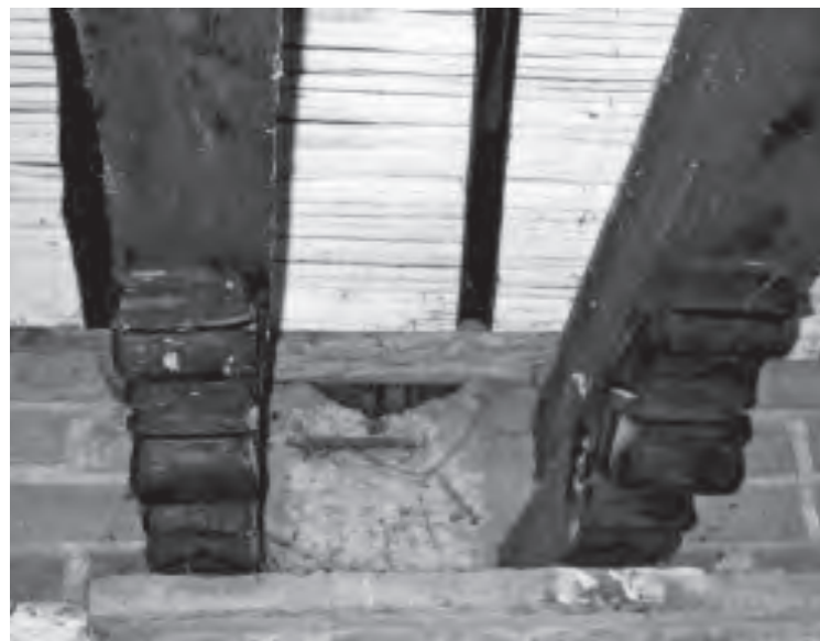
Imagen 58 Detalle de los tirantes recortados para dar paso a la viga de concreto. Fuente: CITCE - Universidad del Valle.
