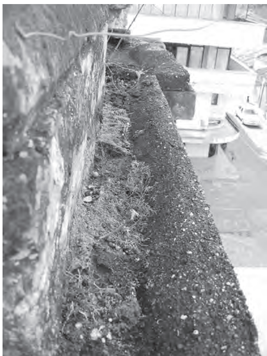
Imagen 135 Las cornisas presentan problemas de empozamientos de agua por inadecuadas intervenciones. Fuente: CITCE - Universidad del Valle
