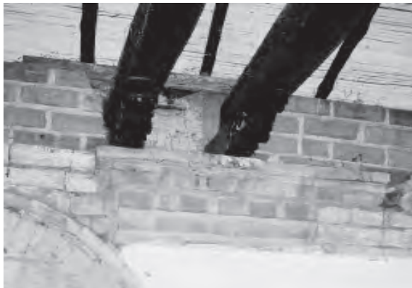
Imagen 84 Los muros longitudinales que definen las naves fueron coronados por grandes vigas de concreto reforzado, cercenando los tirantes desplazando su función estructural a simples elementos decorativos. Fuente: CITCE - Universidad del Valle.
