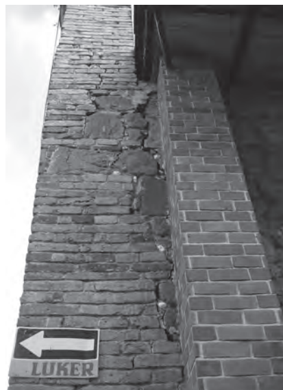
Imagen 108 La fachada principal se encuentra dilatada de la fachada lateral. Fuente: CITCE - Universidad del Valle
