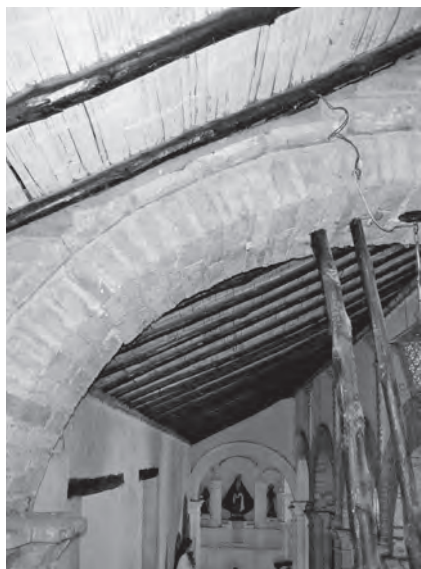
Imagen 107 Los arcos que conforman los coros laterales, reconstruidos después del sismo de 1962, presentan fisuras y fracturas. Fuente: CITCE - Universidad del Valle
