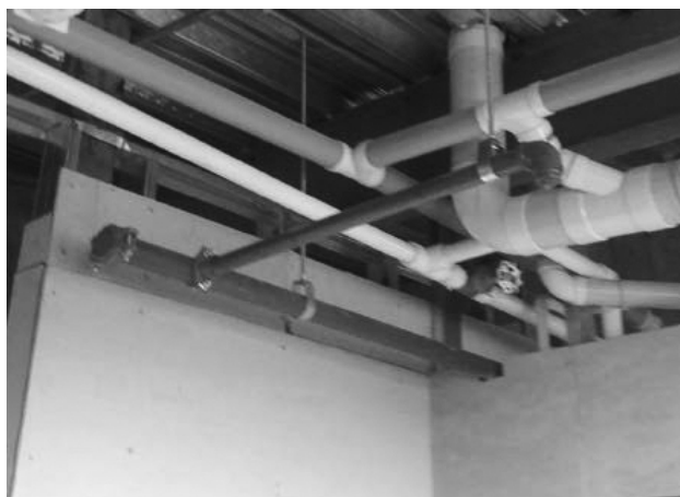
Figura 37. Instalaciones hidrosanitarias y contra incendios
