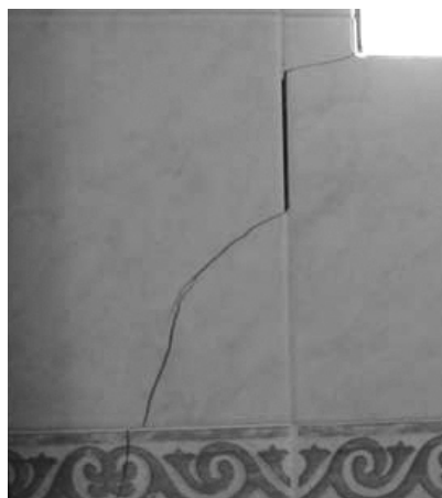
Figura 23. Fisuras en acabados
