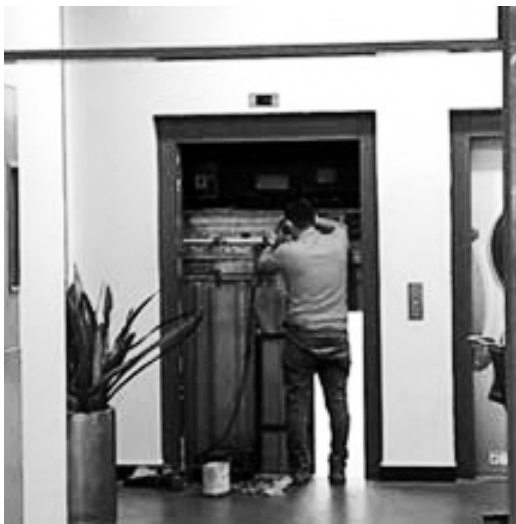
Figura 52. Mantenimiento de ascensores
