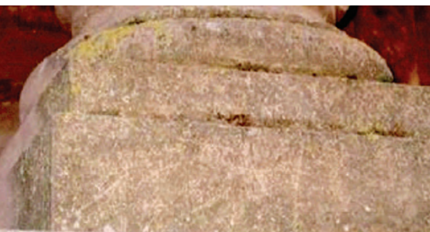
Pátina biogénica en areniscas
