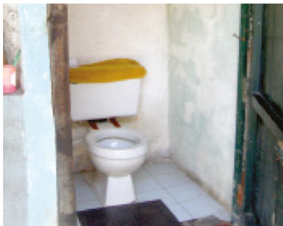
Decoloración de muros
