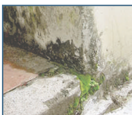
38. Fuente: Curso patología de la construcción.
