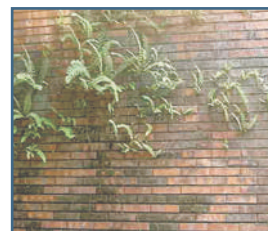
36. Fuente: Curso patología de la construcción.
