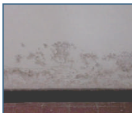
18. Fuente: Curso patología de la construcción.
