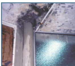
47. Fuente: Curso patología de la construcción
