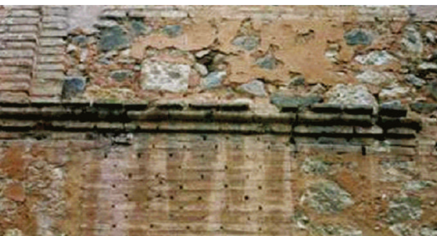
Pátina de lavado sobre ladrillo
