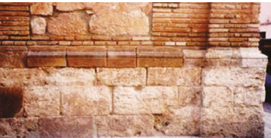
Pátina de suciedad en bloques de calizas
