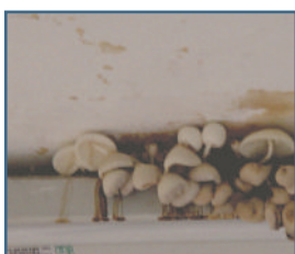
37. Fuente: Curso patología de la construcción.
