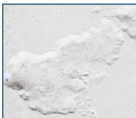
42. Fuente: Curso patología de la construcción.
