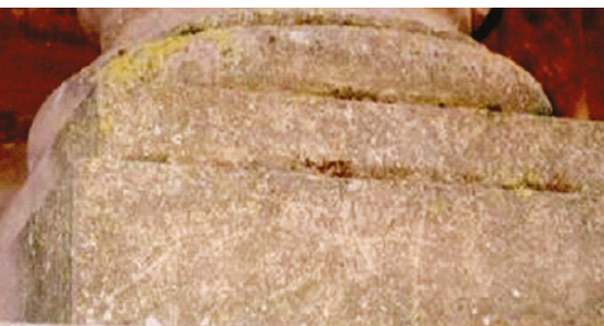
Pátina biogénica en areniscas
