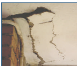
45. Fuente: Curso patología de la construcción.
