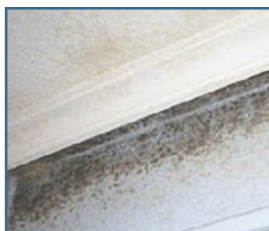
20. Fuente: Curso patología de la construcción
